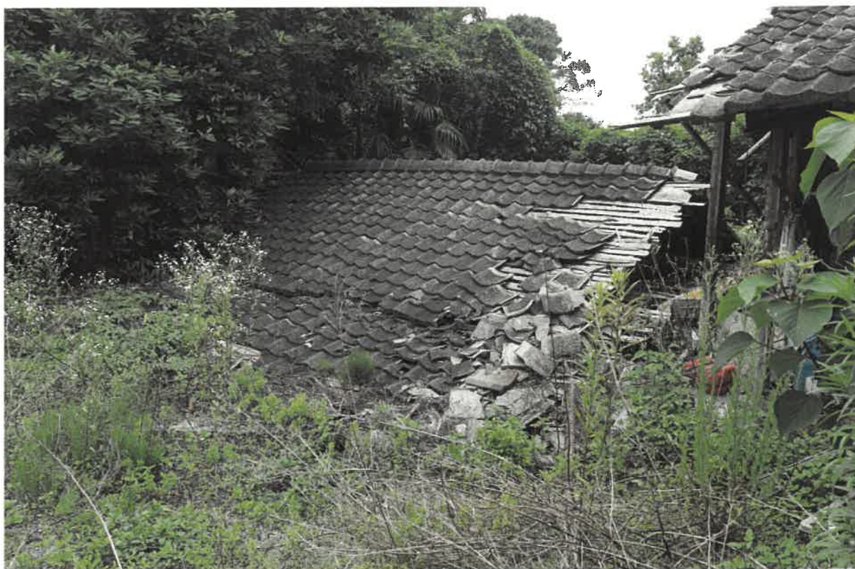
西側倒壊部分
