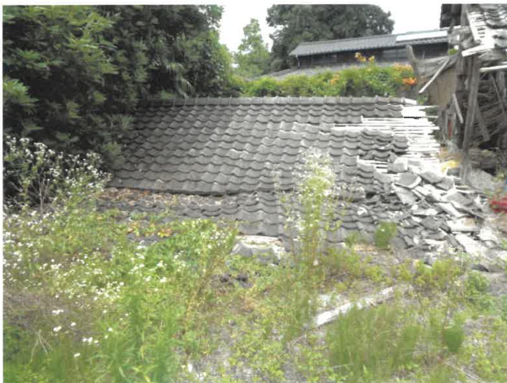
(写真 4) 符号 1 の附属建物 (倒壊部分)
