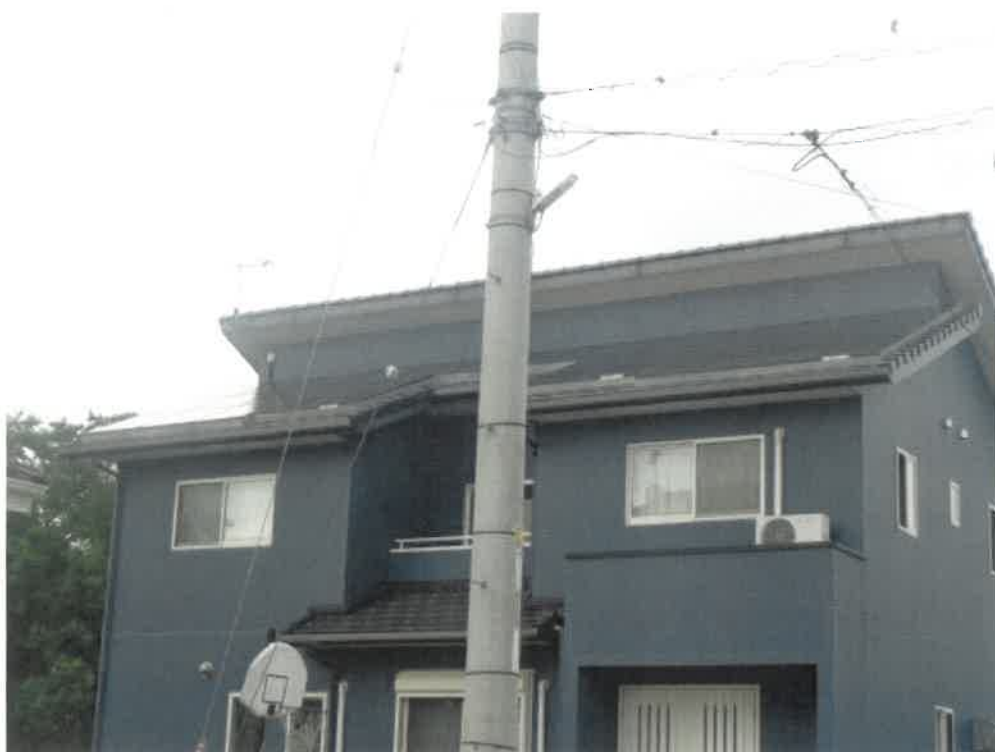
(写真2) 本件建物に設置されている太陽光発電システム
