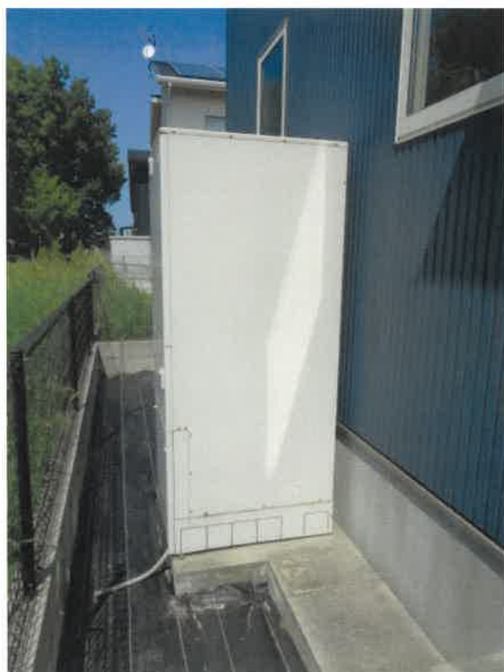
(写真3) エコキュート
