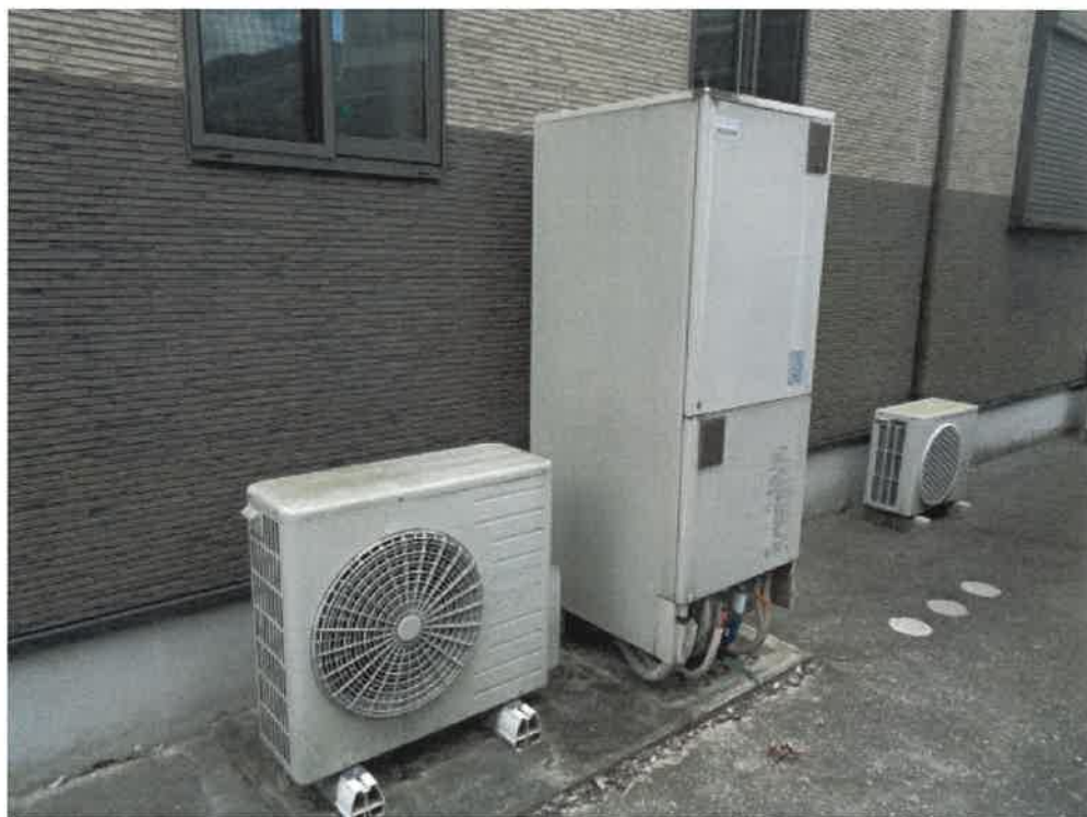
(写真3) ヒートポンプ式給湯器
