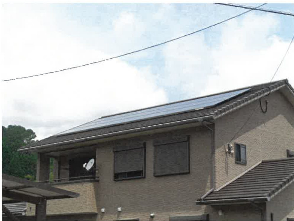
(写真4) 太陽光発電システム
