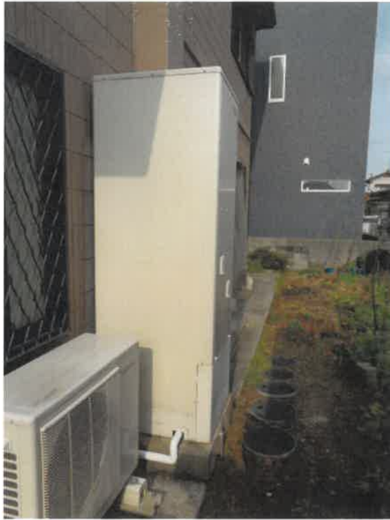
(写真8) 売却対象物件(従物)であるヒートポンプ式給湯機
