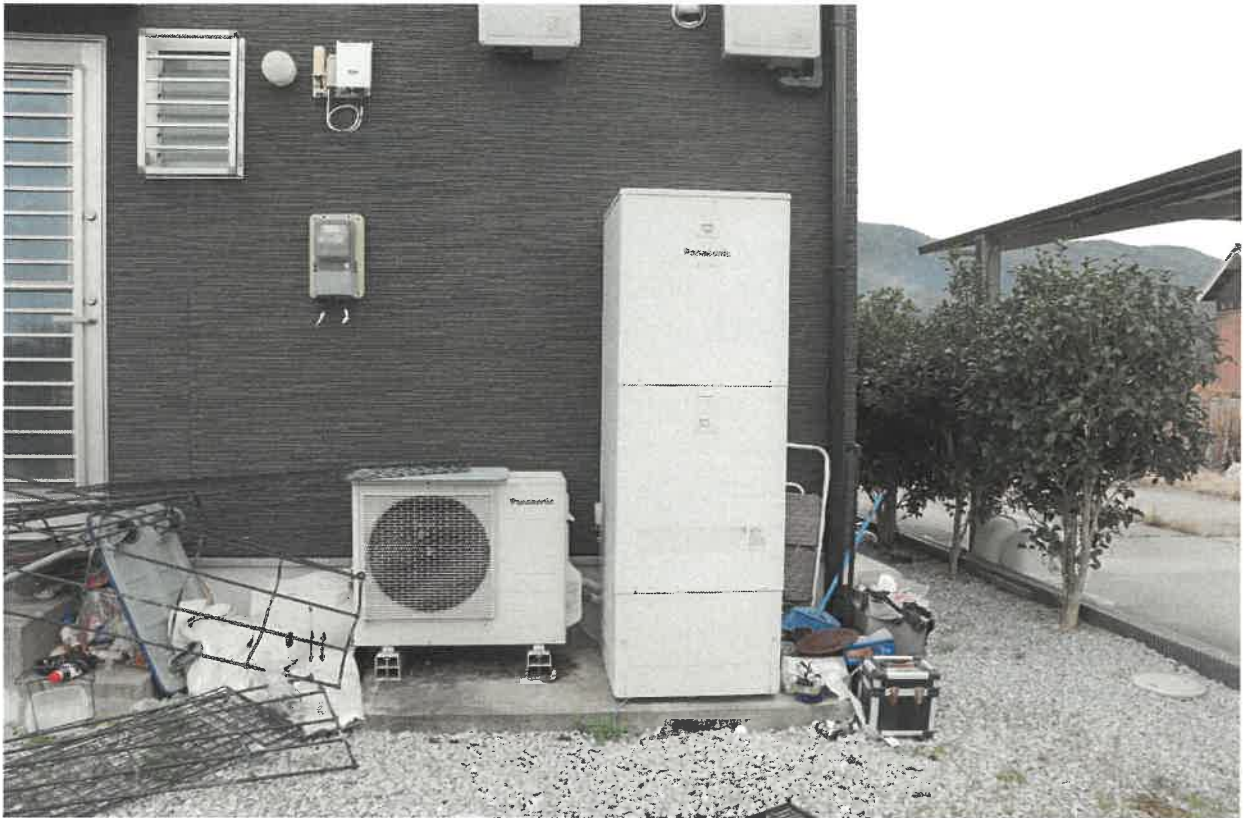
ヒートポンプ式給湯器ユニット
