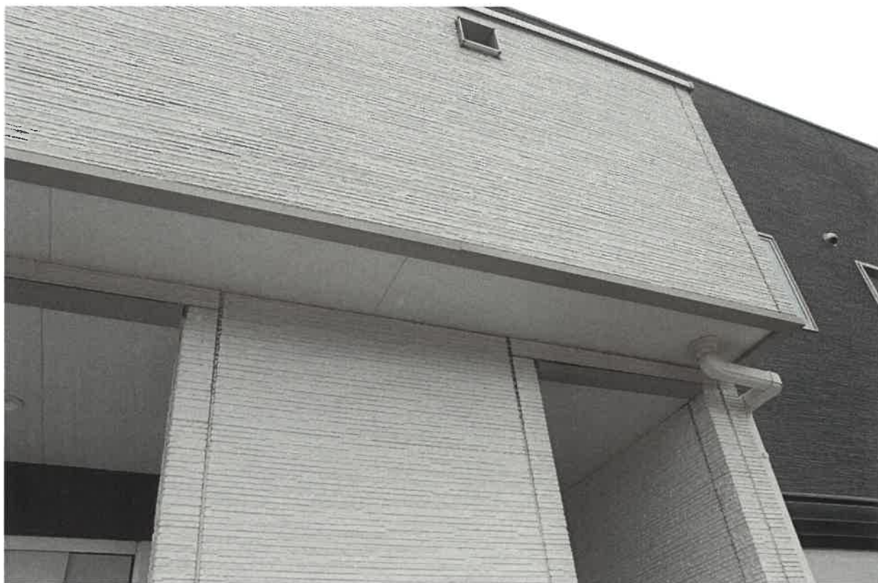
サイディング外壁のコーキング劣化
