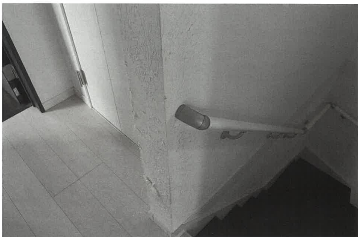
壁クロスの損傷（2階・階段附近）
