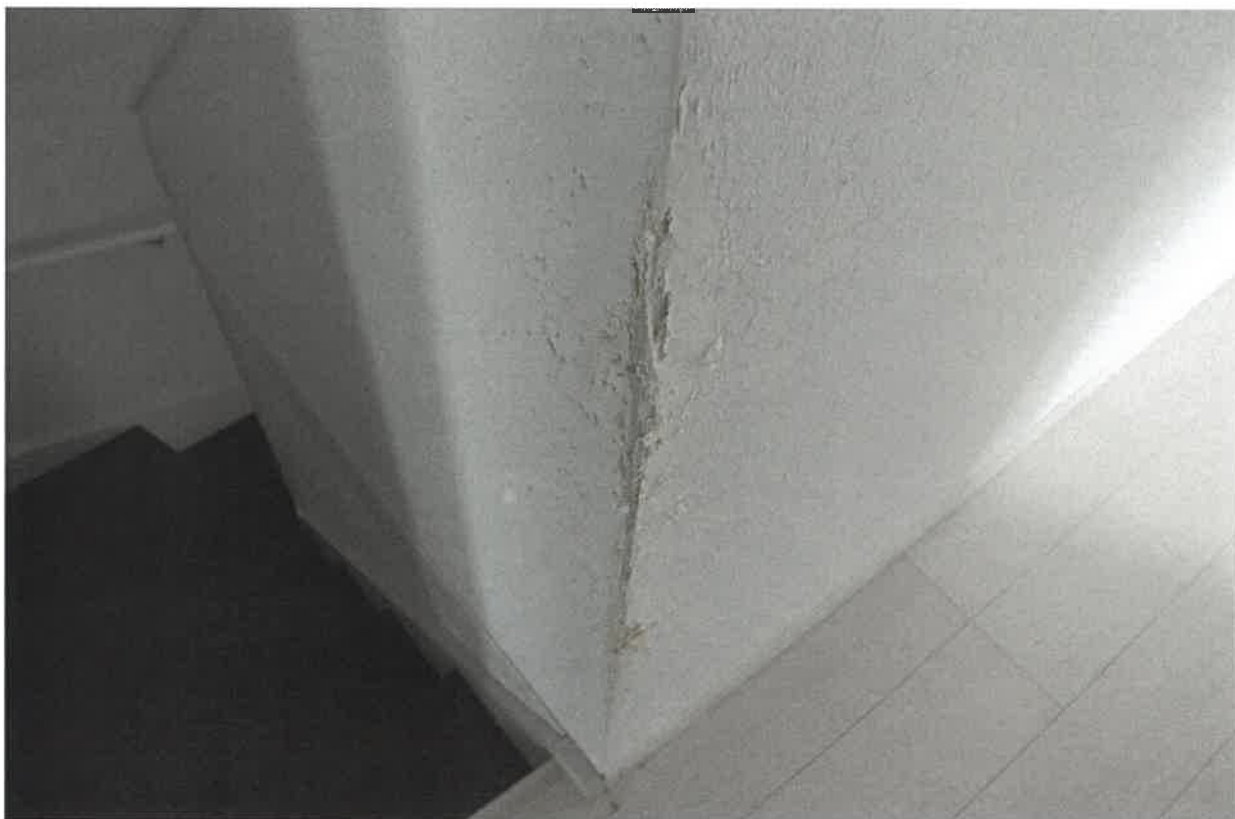
壁クロスの損傷（2階・階段附近）
