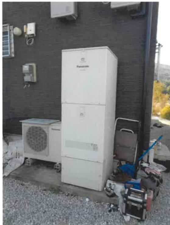
(写真8) ヒートポンプ式給湯器
