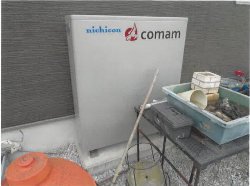
(写真7) 本件建物に設置された家庭用蓄電ユニット
