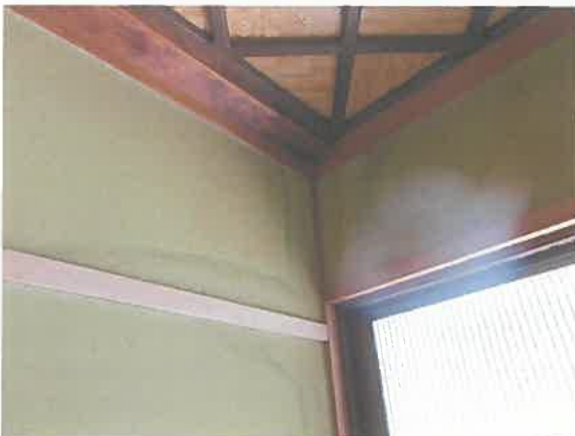
物件 4 内壁の雨染み
