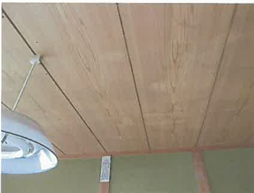
物件 4 天井の雨染み
