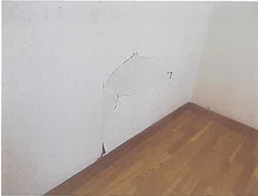
物件 4 内壁の破損
