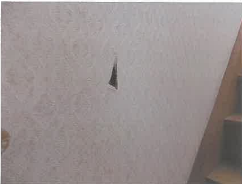
物件 4 内壁の破損
