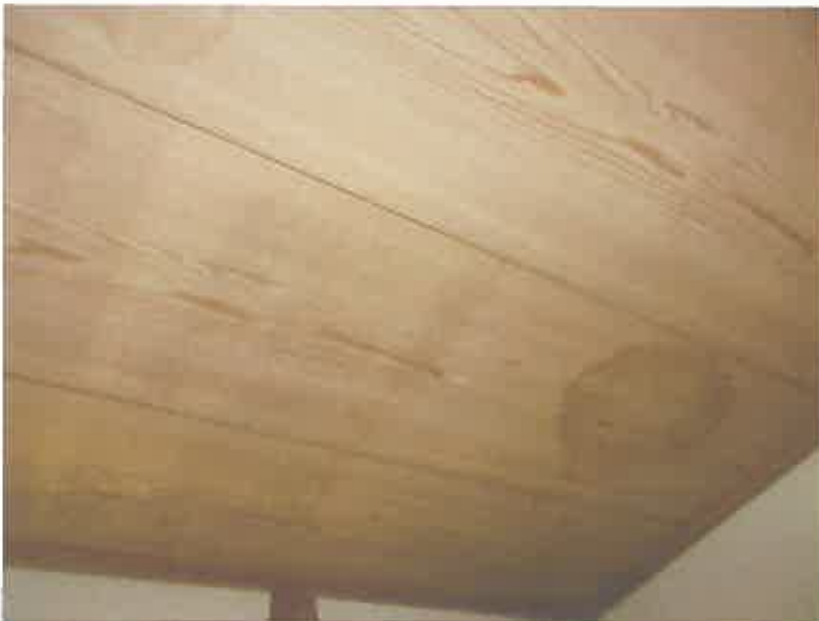
物件 4 天井の雨染み
