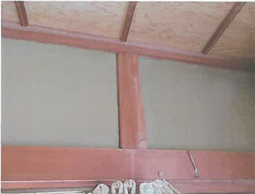
物件 4 内壁の雨染み
