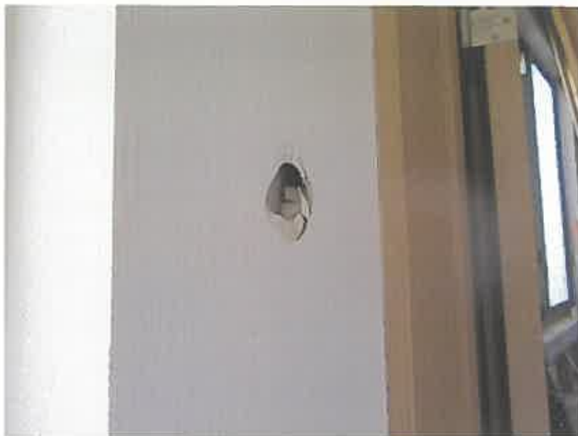
物件 2 内壁の破損
