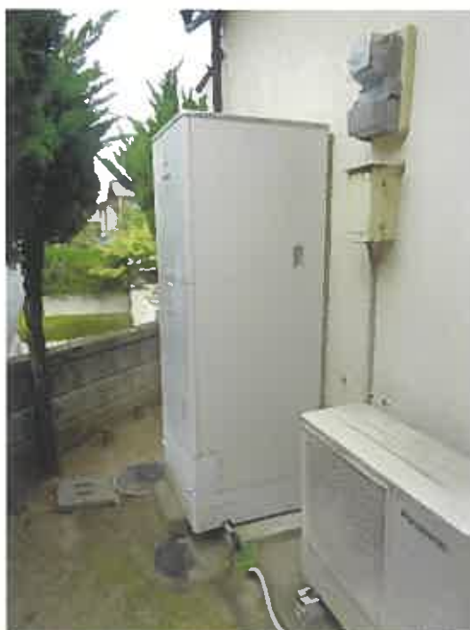
(写真6) 売却対象物件(従物)であるヒートポンプ式給湯機
