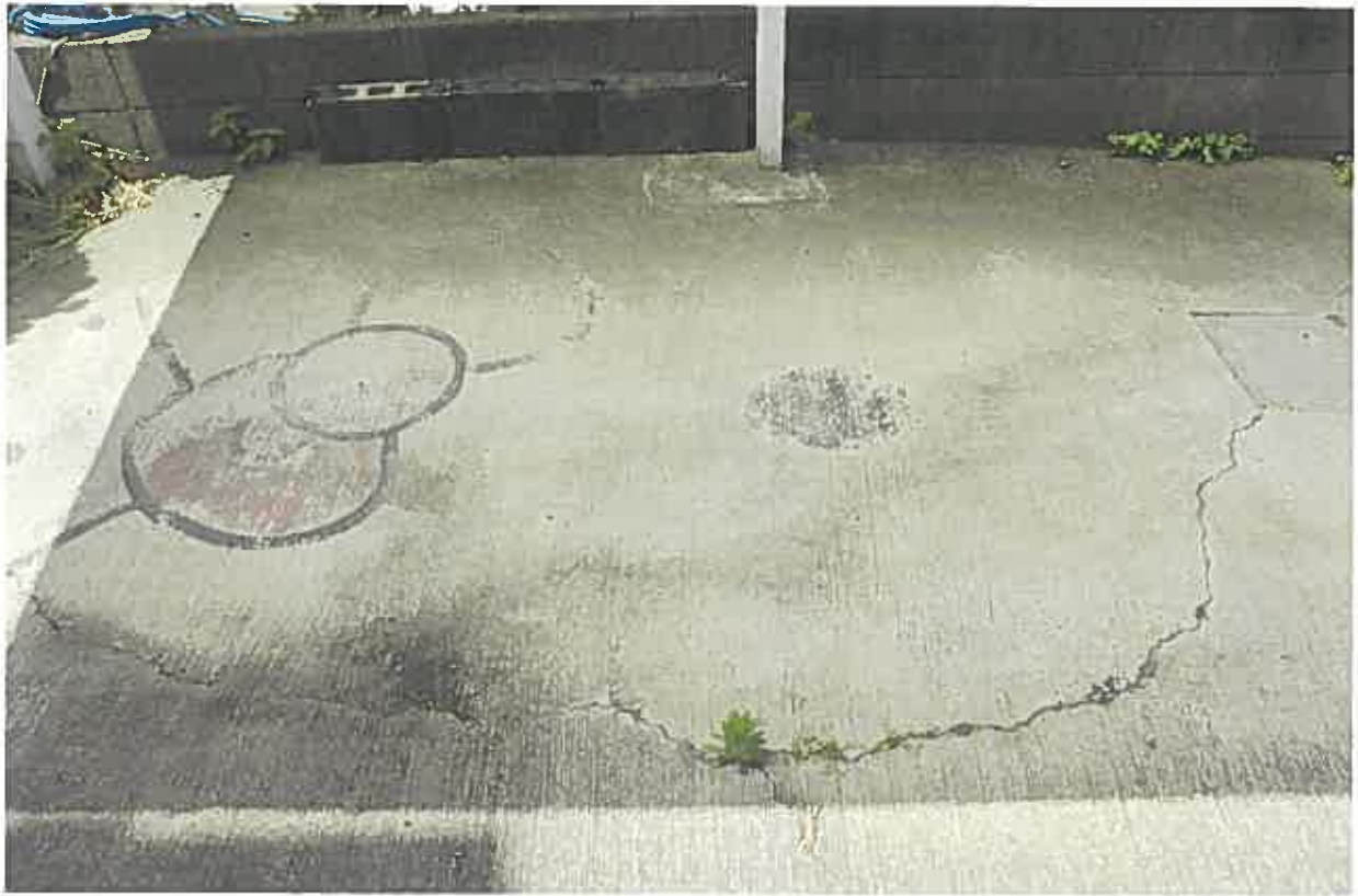
敷地内の舗床亀裂箇所（カーポート周辺）
