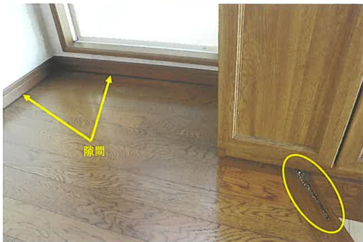
白蟻被害箇所（玄関框・ホール）
