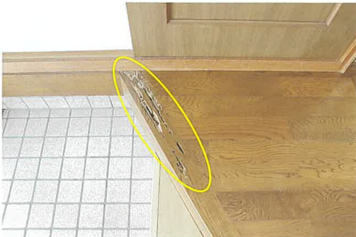
白蟻被害箇所（玄関上がり框）
