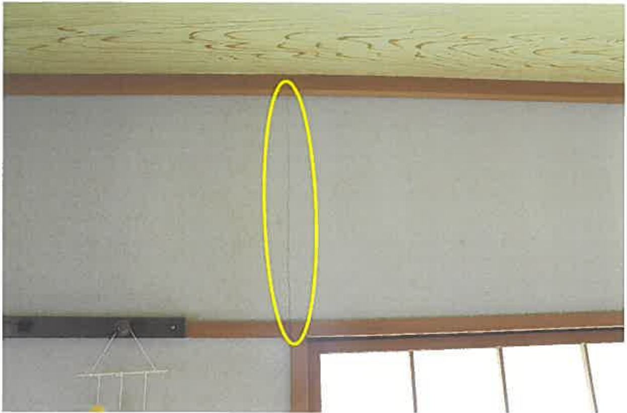
壁の亀裂（1階・和室）
