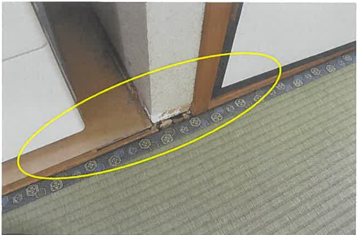
白蟻被害箇所（1階・和室）
