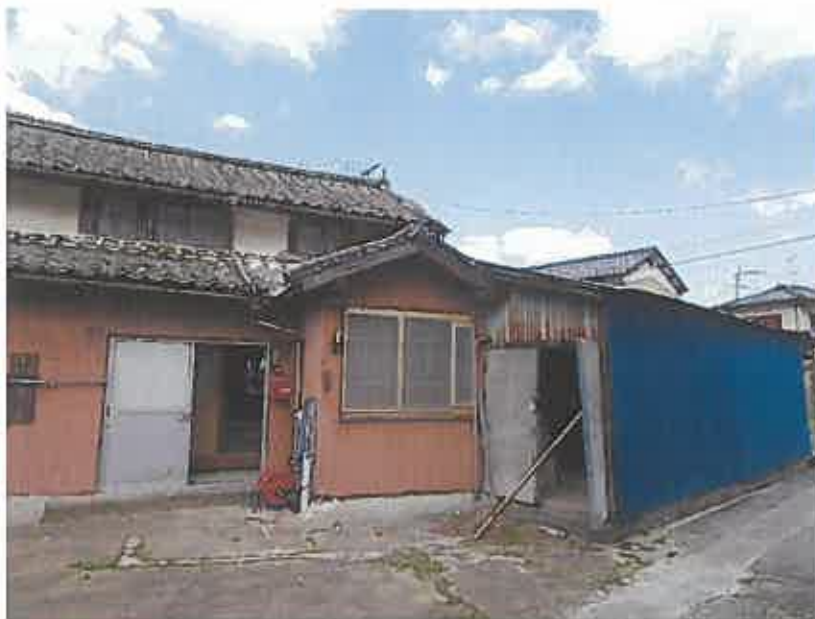
物件 2（附属建物） 未登記増築部分
