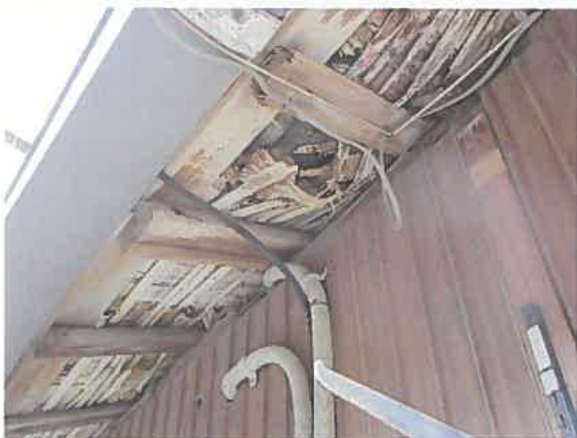
物件 2（附属建物） 軒裏の損壊
