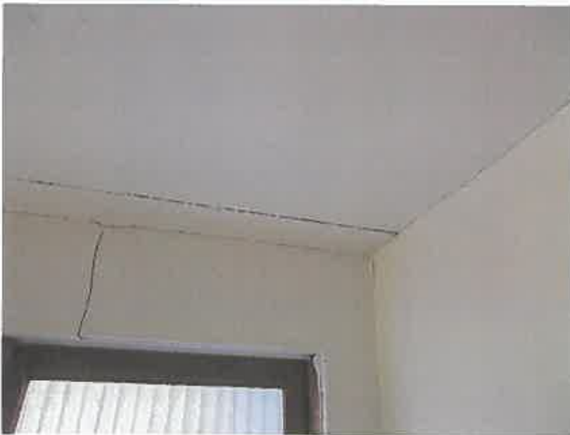
物件 2 内壁のクラック
