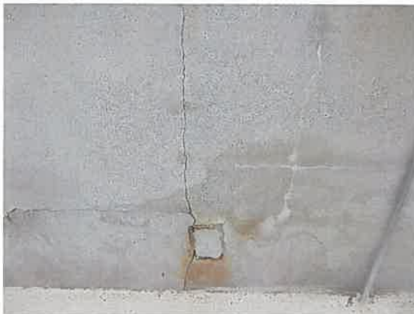
物件 2 外壁のクラック
