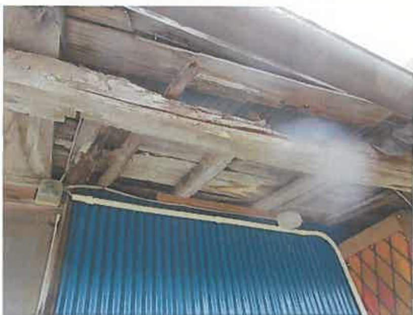
物件 2（附属建物） 軒裏の損壊
