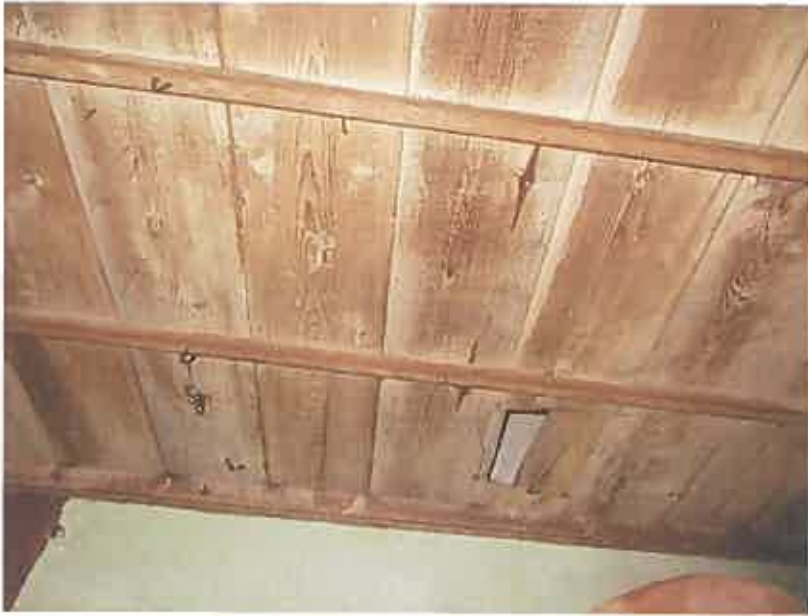
物件 2 天井の破損
