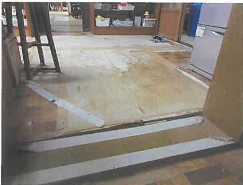
物件 2 床の破損
