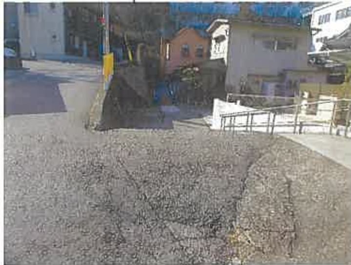
写真⑤目的外土地及びブロック塀
