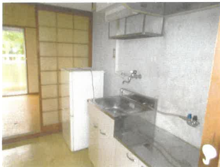
写真②⑥本件建物（物件7）210号室
