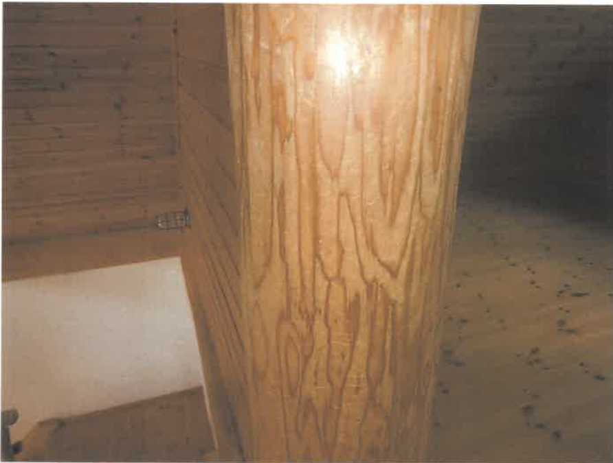
物件 2 2階柱の傷
