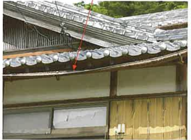
雨樋の損傷状況
