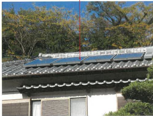
ソーラーパネルの固着状況
