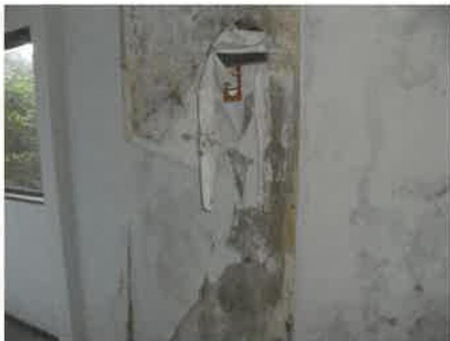
壁面の崩落状況
