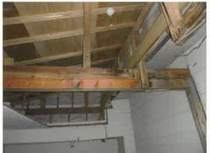
車庫天井の崩落状況
