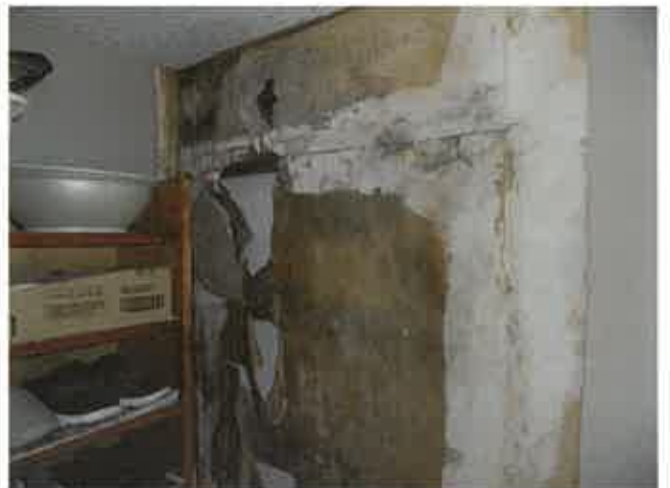
壁面の朽廃状況(リネン室)
