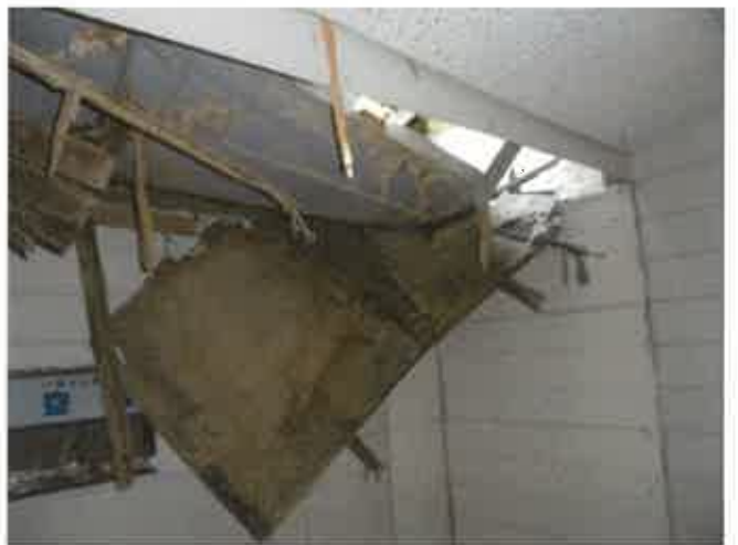
車庫天井の崩落状況
