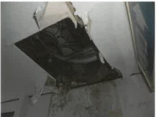
天井の崩落状況
