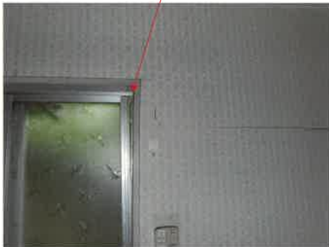
窓枠が傾いている状況(旧厨房)
