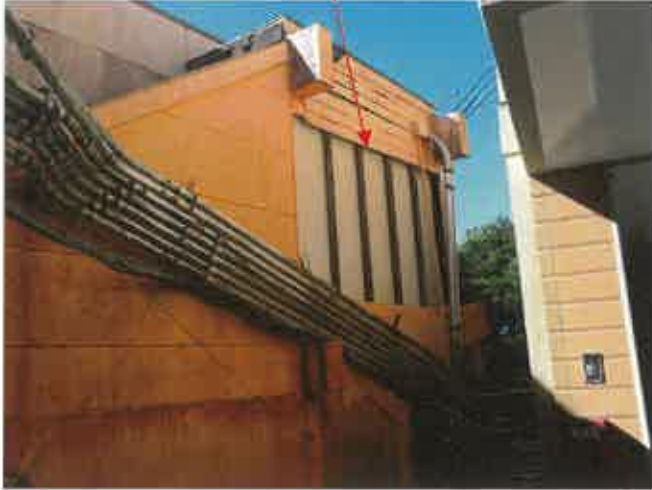
物件 19 建物壁面の崩落状況
