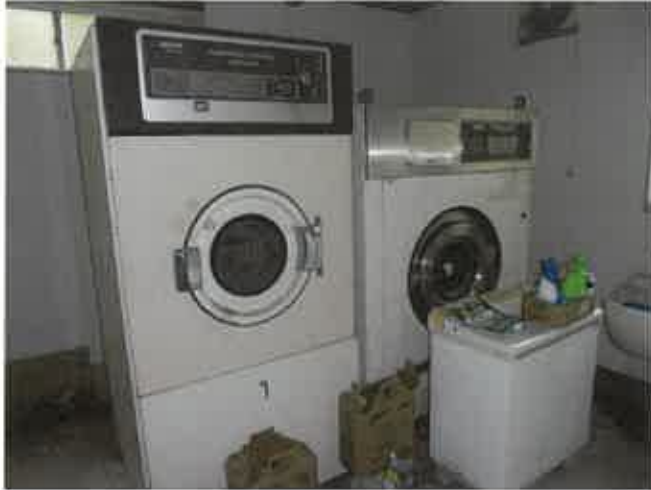
乾燥機の設置状況
