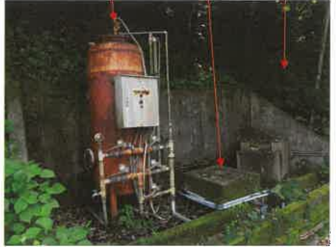
浄化装置制御盤 浄化槽 物件6
