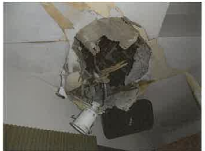
客室天井の崩落状況
