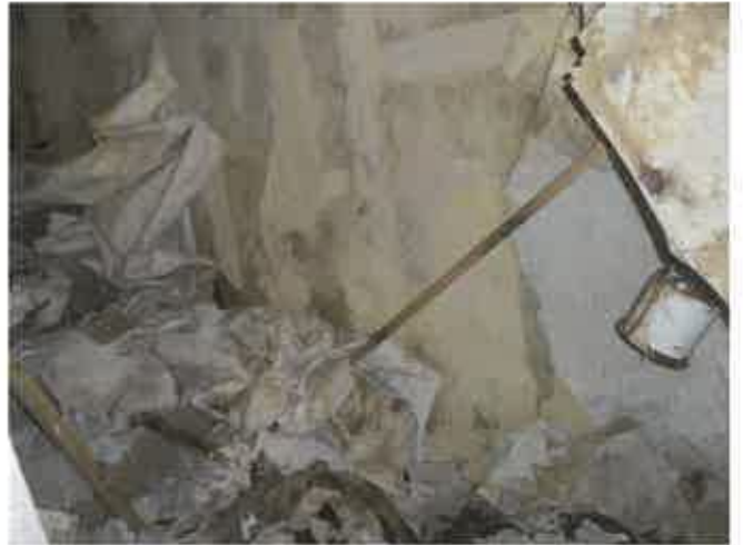
階段壁面の崩落状況
