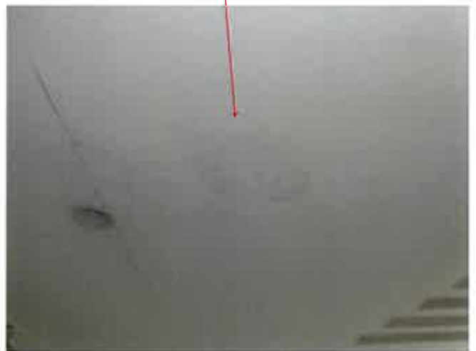
更衣室天井の雨漏り痕
