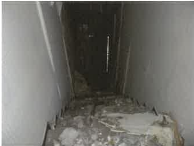
階段天井の崩落状況
