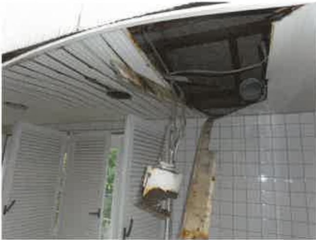
客室天井の崩落状況
