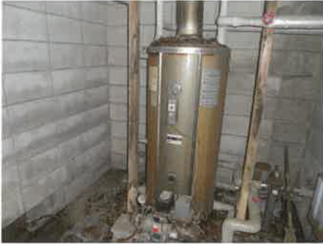
ボイラー室内部
