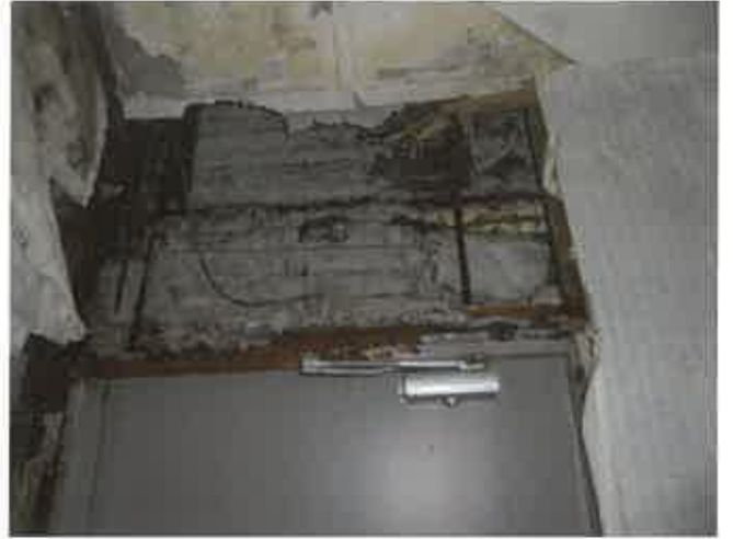
玄関壁面の崩落状況
