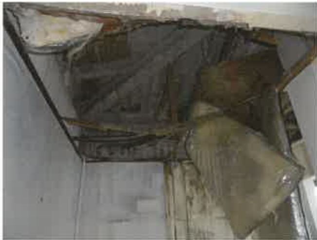
天井の崩落状況
