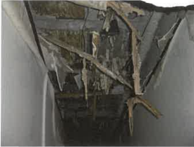
天井の崩落状況
