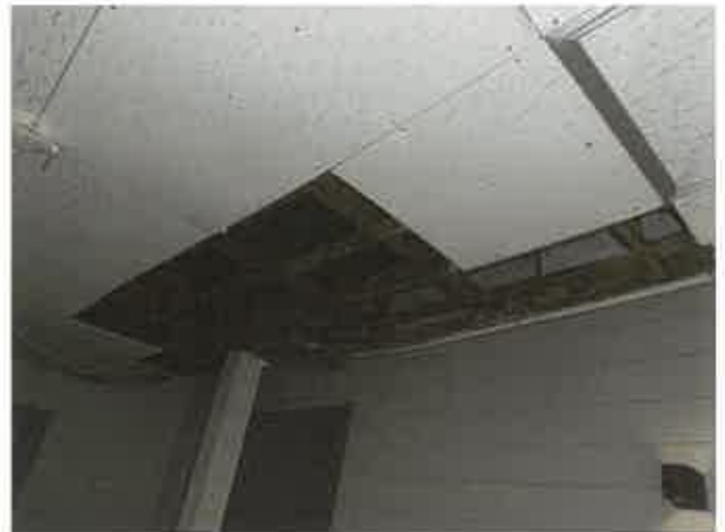
車庫天井の崩落状況
