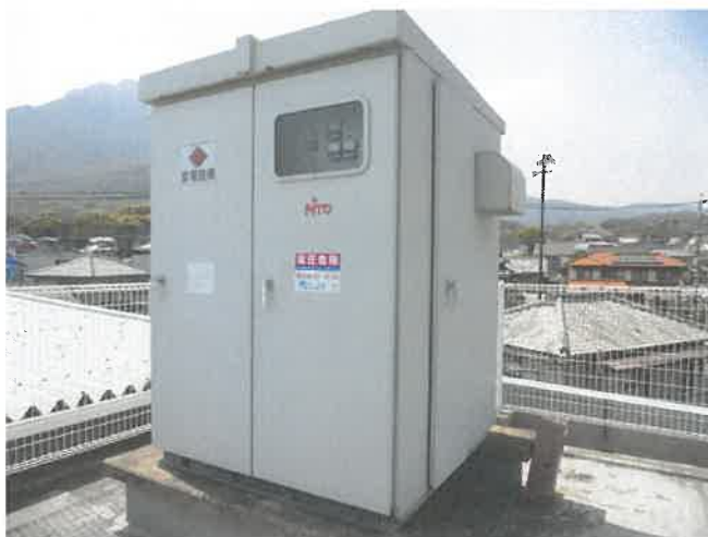
変電設備(屋上)
