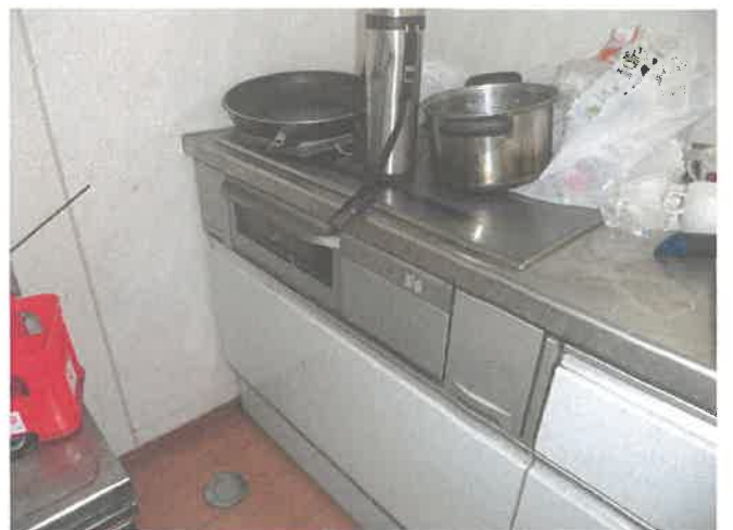
I Hコンロの固着状況
