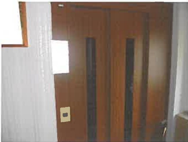
エレベーター
