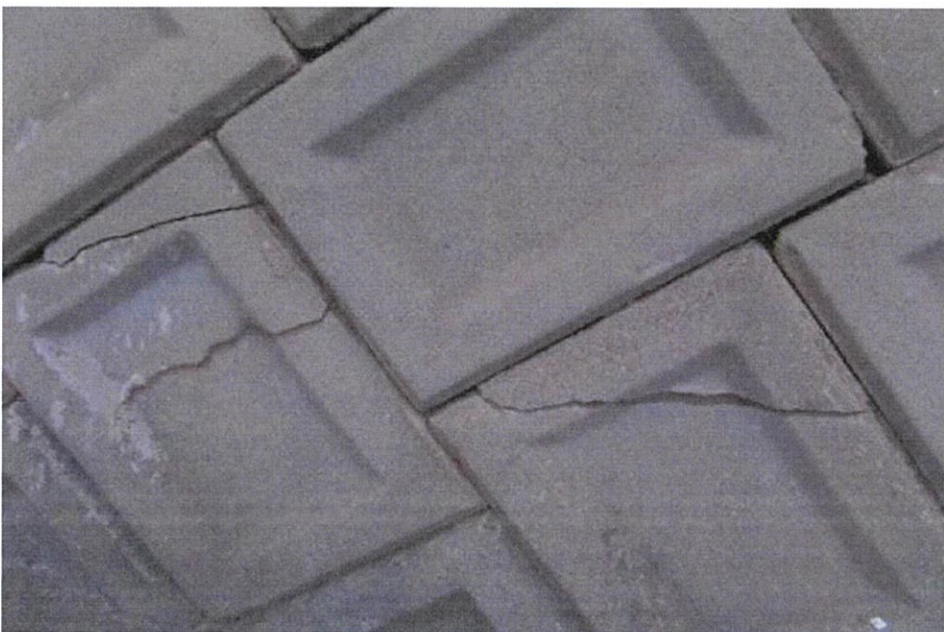
No. 9 間知ブロックの損傷状況 を撮影
