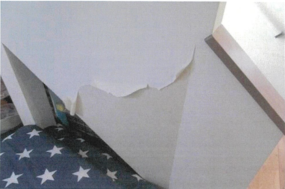
No. 9 壁クロスの損傷を撮影
