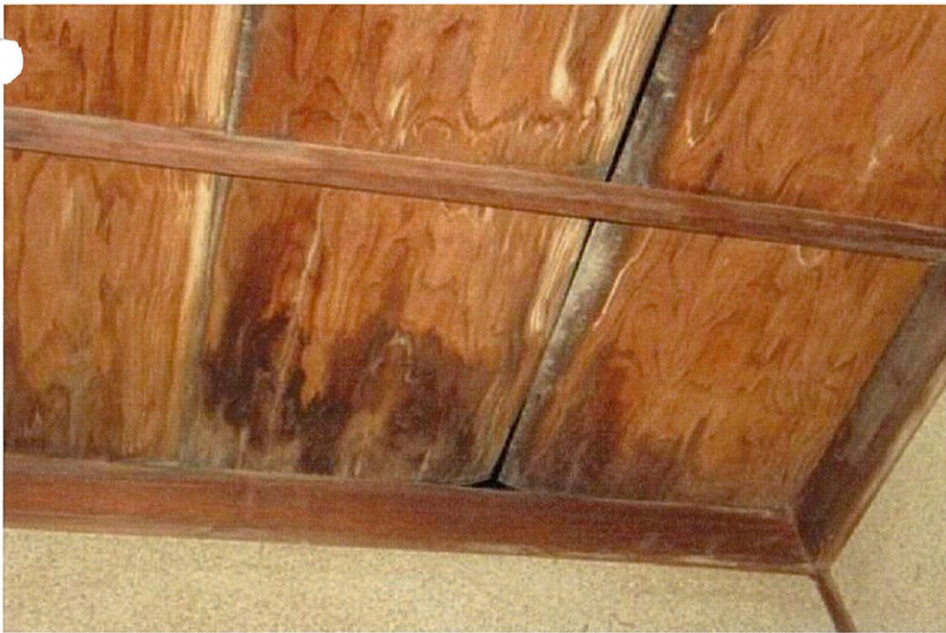
No. 11 雨漏り跡を撮影
