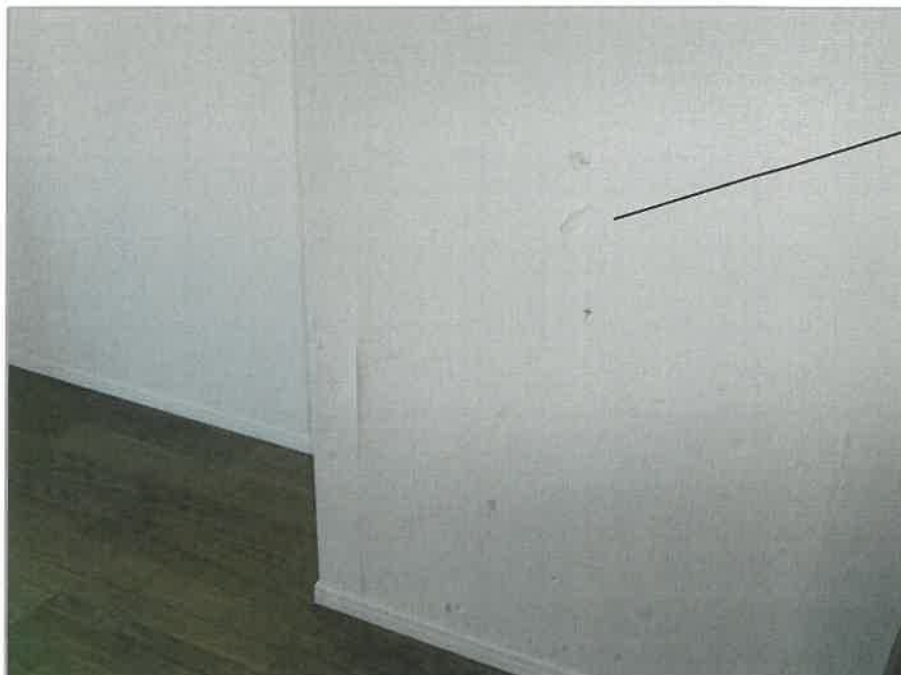
5 室内の状況 (破損状況)
