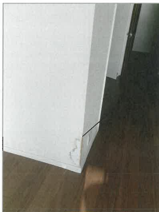
6 室内の状況 (破損状況)
