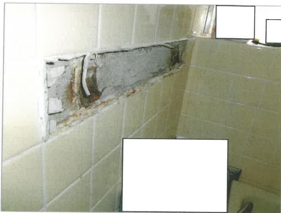
5 室内の状況 (破損状況)
