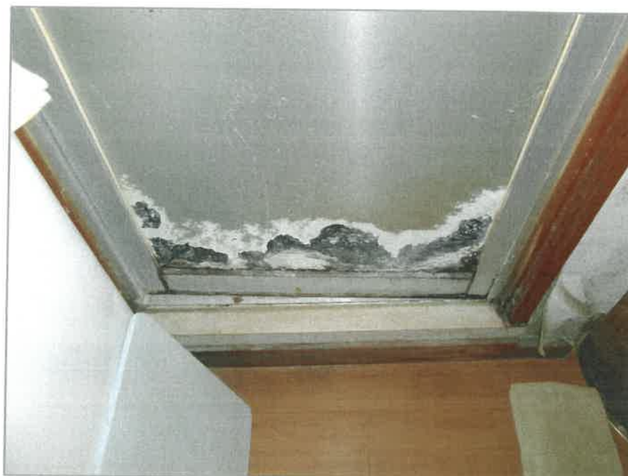
6 室内の状況 (破損状況)
