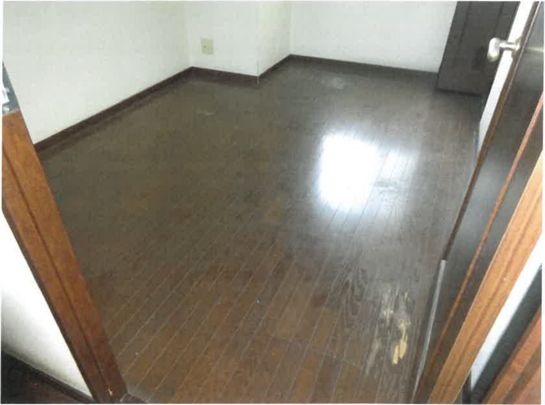
7 洋室(2)の床の傷み
