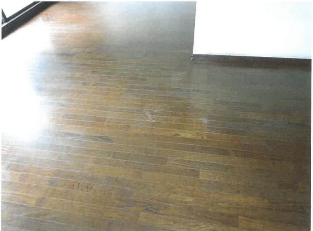
8 リビングの床の傷み
