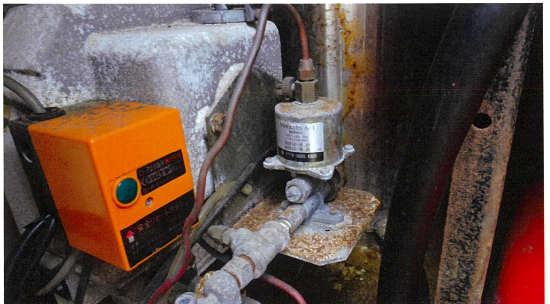
写真21 高圧温水洗浄機の内部
