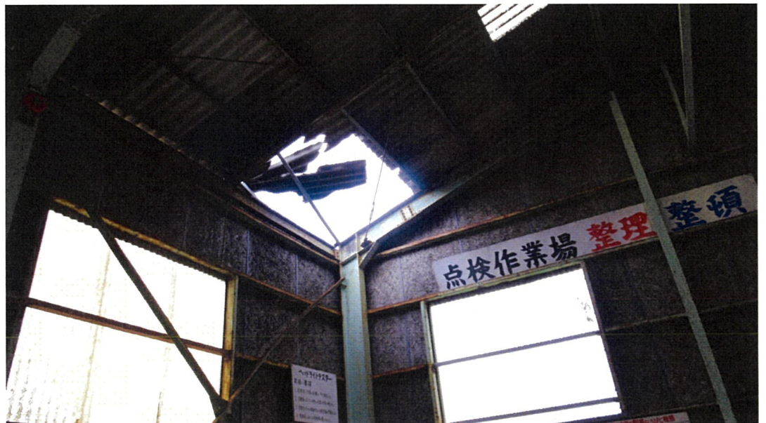
写真11 屋根が壊れている。
