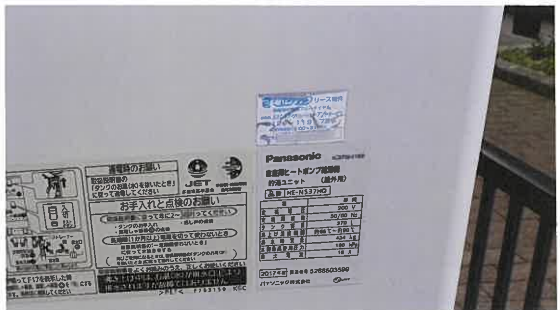
電気温水器のシール
