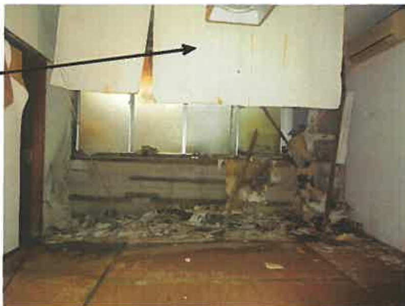
⑦ 雨漏り・天井の崩れ 物件4建物 103号室
