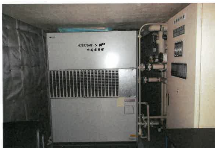
写真 7 4 物件 2 主建物・4 階機械室
