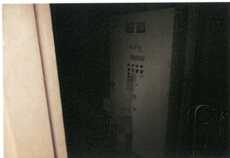
写真 9 3 物件 4 建物・1 階機械室 2
