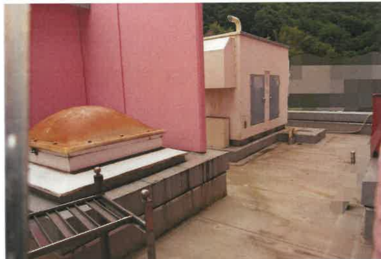
写真5 3 物件2主建物・3階機械室
