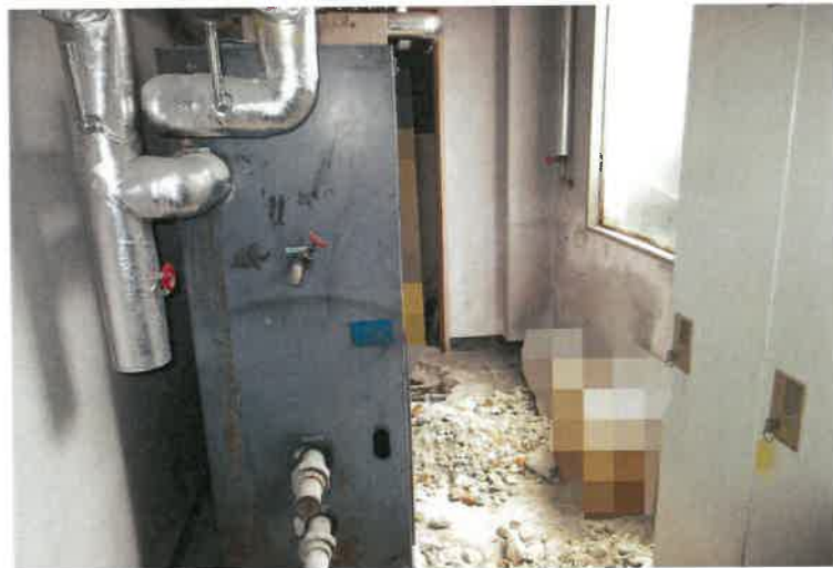
写真 9 2 物件 4 建物・1 階機械室 1
