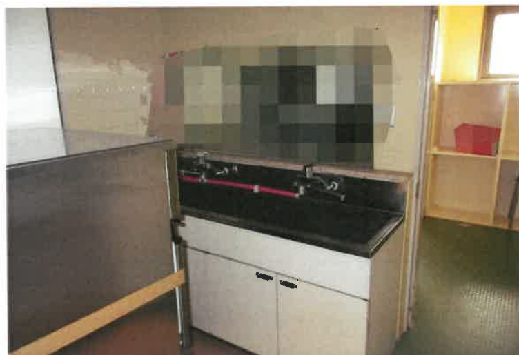
写真5 4 物件2主建物・3階洗面室
