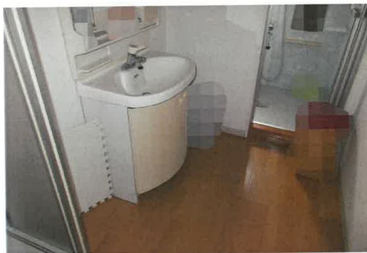
写真107 物件4建物・2階洗面所
