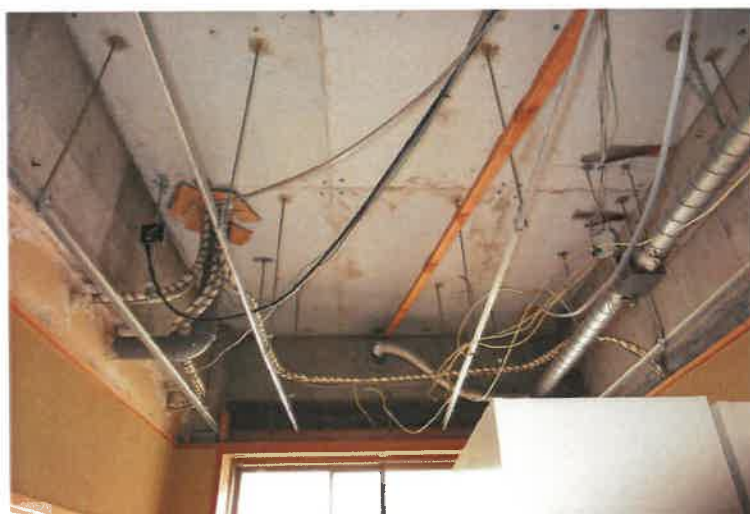
写真 7 1 物件 2 主建物・4 階寮室 2 天井部分
