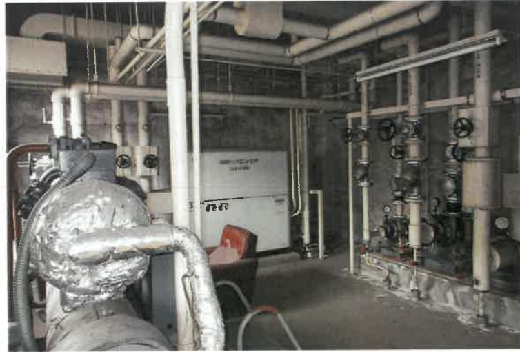
写真 4 0 物件 2 主建物・2 階機械室
