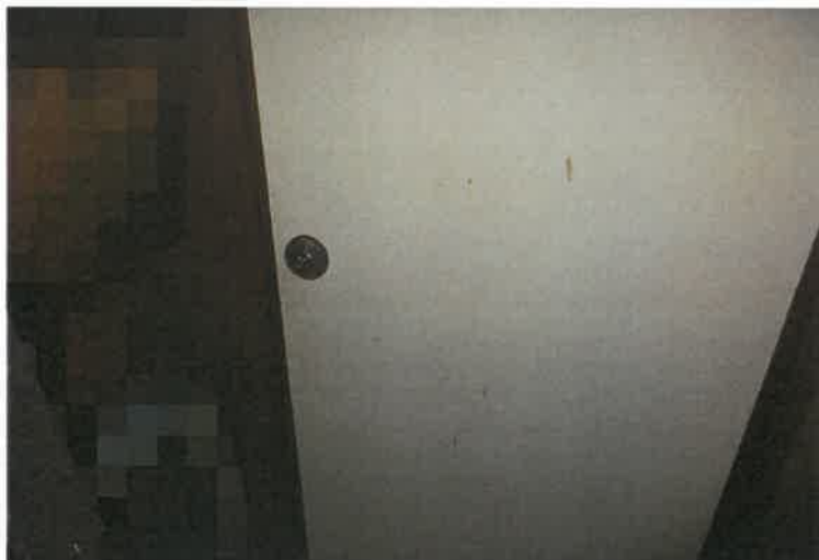
写真17 物件2建物・2階トイレ(ドア)
