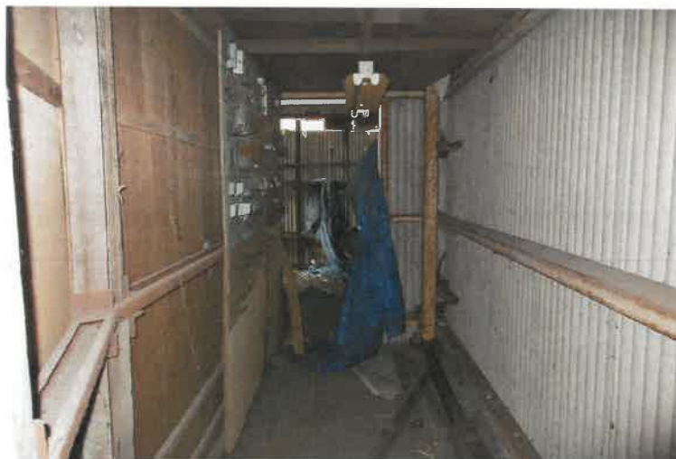
写真1 3 1階物置（入り口付近）
