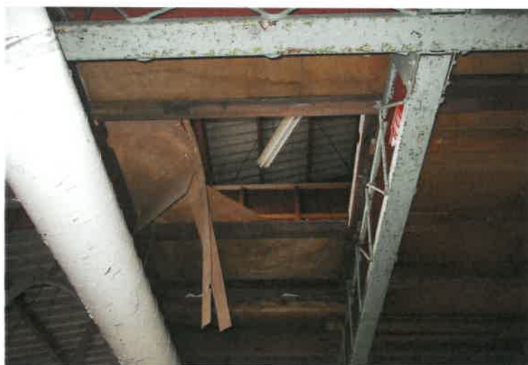
写真1 5 1階天井（穴あき・2階物置部分）
