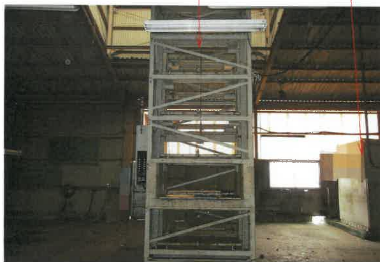
写真11 1階東側 金型保管機 変電設備
