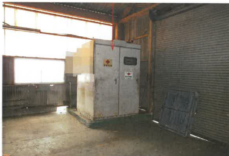
写真10 1階南東側 変電設備
