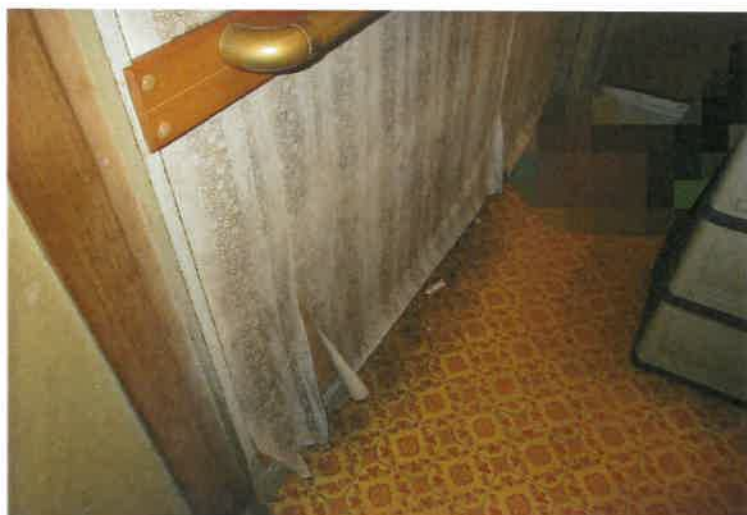
写真12 1階洗面所（壁剥がれ）
