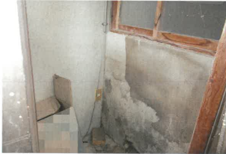
写真 2 2 物件 2 建物・北東側物入（浴室東側）
