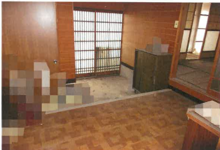
写真12 物件2建物・小上がり・玄関
