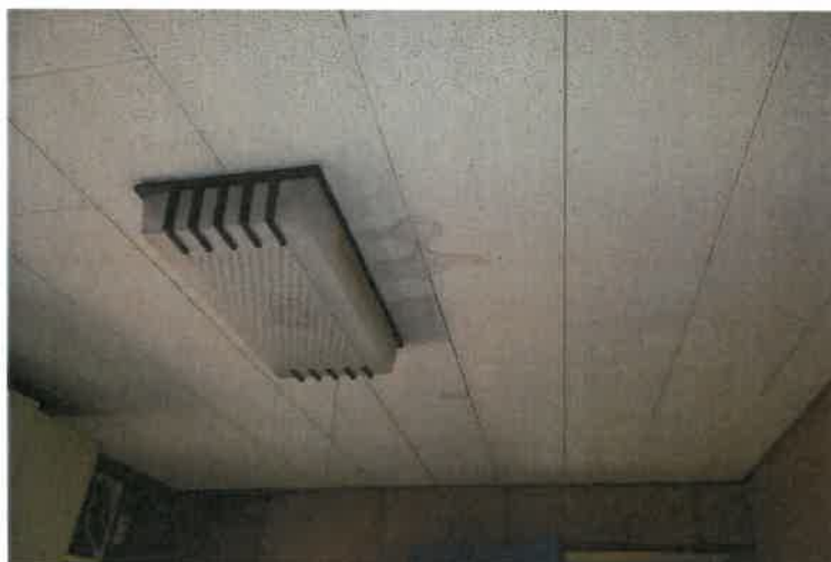
写真29 物件3建物・リビング天井水シミ
