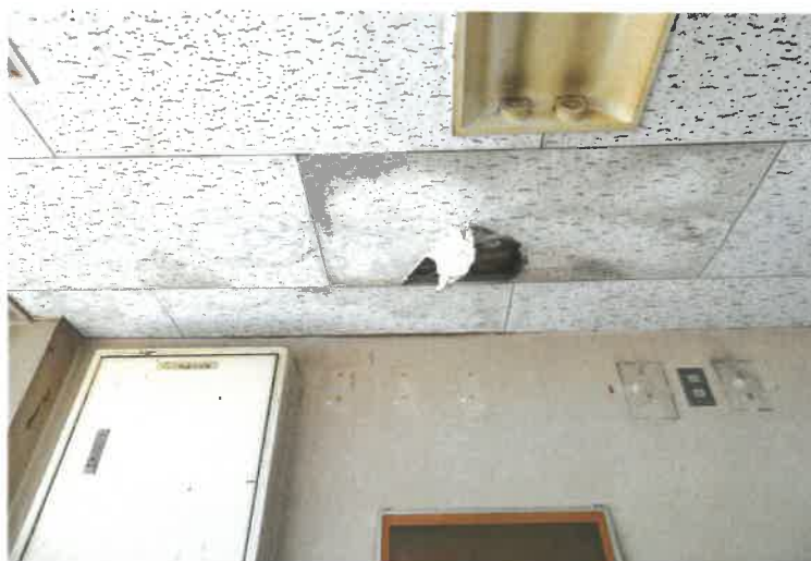
写真 3 9 2階北西側事務室の天井(雨漏り)の状況
