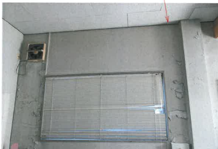
写真8 1階事務所北側壁面 隙間
