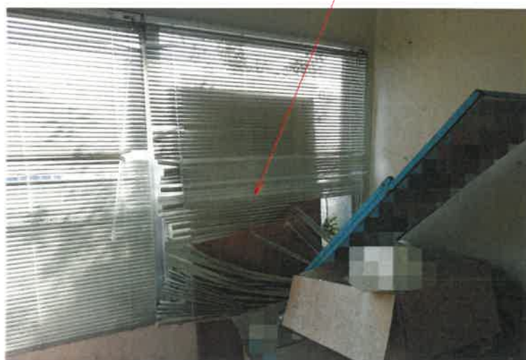
写真12 2階事務所東側部分（窓ガラス割れ）
