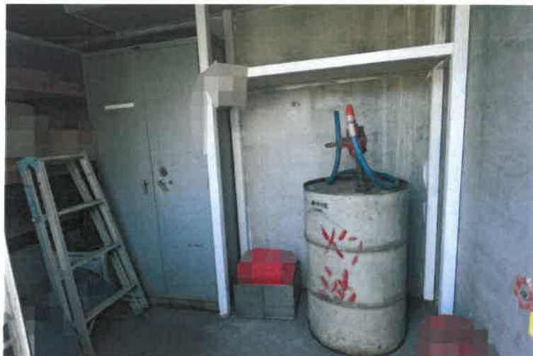
写真10 1階ボイラー室
