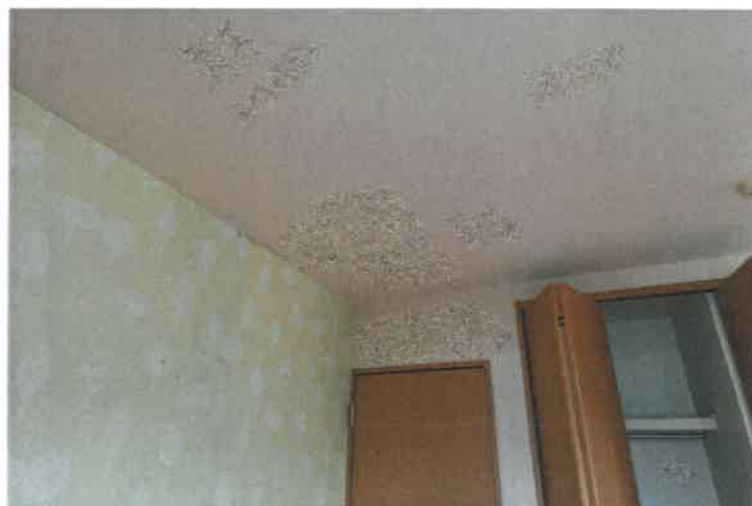
写真21 2階西側洋室 (天井部分落書)
