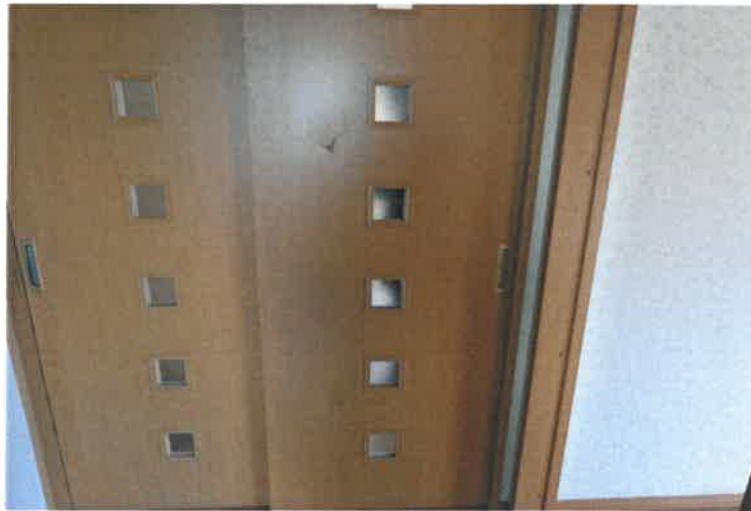
写真5 1階ホール東側扉（キズ・凹み）
