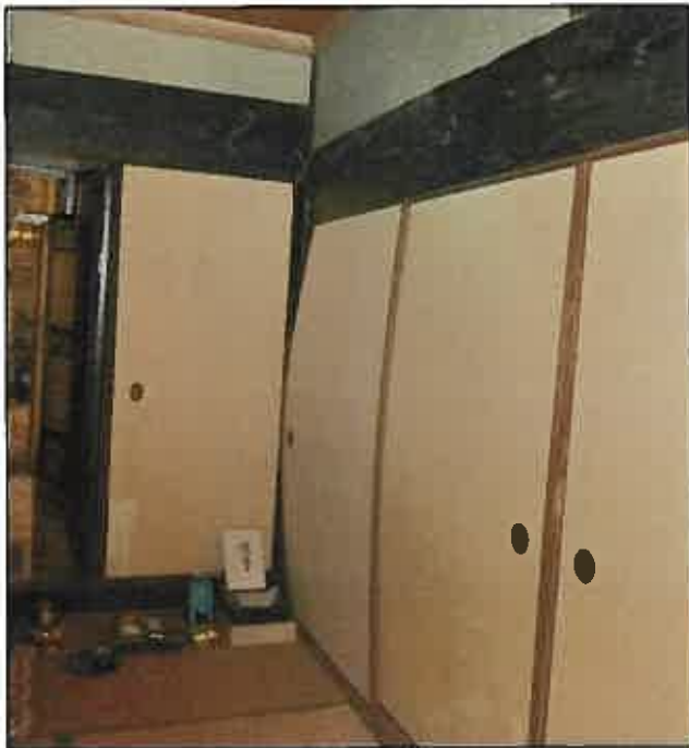
写真 44 主建物南側和室の歪んだ襖
