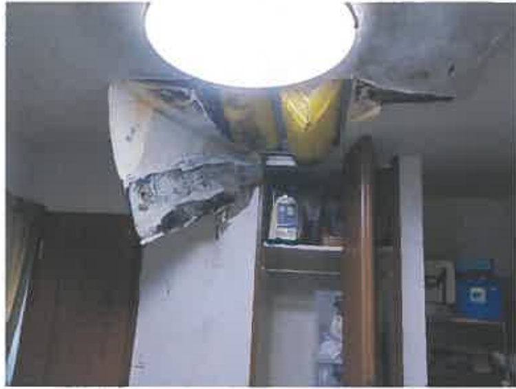
写真16 天井材等の破れ
