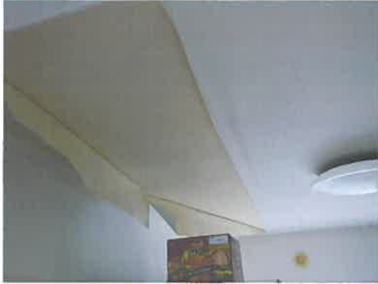
写真58 302号室 天井クロスの剥離
