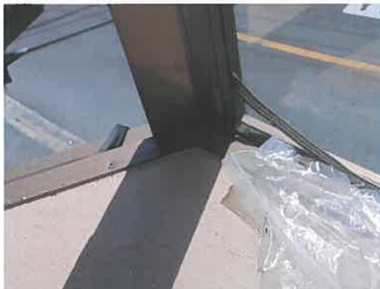
写真116 401号室 (パッキンの外れ)
