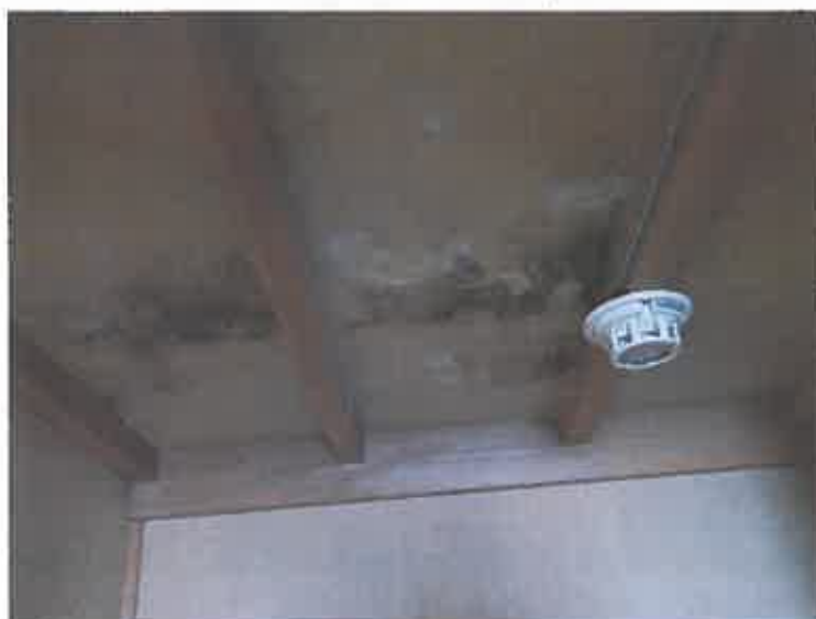
写真53 207号室（漏水箇所・カビ）
