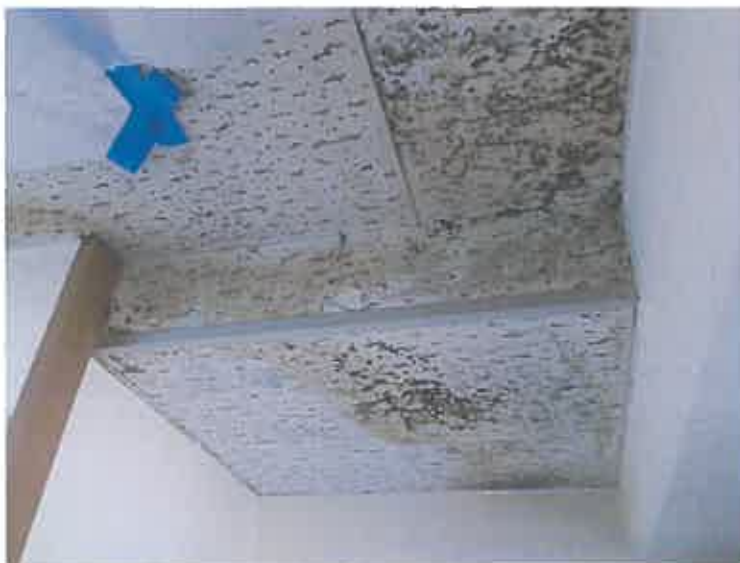
写真48 207号室（漏水箇所・カビ）
