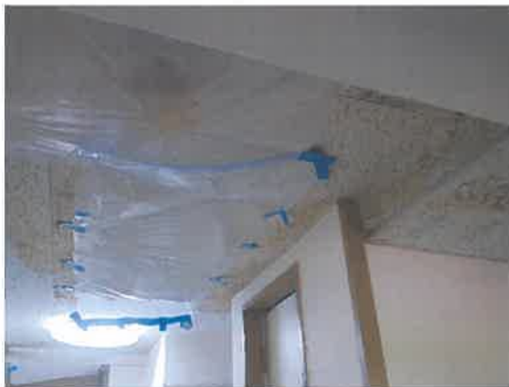
写真47 207号室（漏水箇所・カビ）
