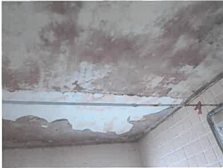
写真1 3 浴室天井の剥離
