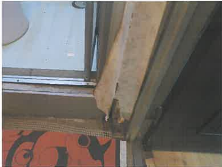
写真14 浴室扉脇の腐食
