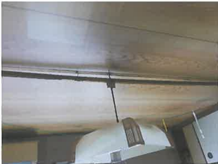
写真21 天井板の剥がれ
