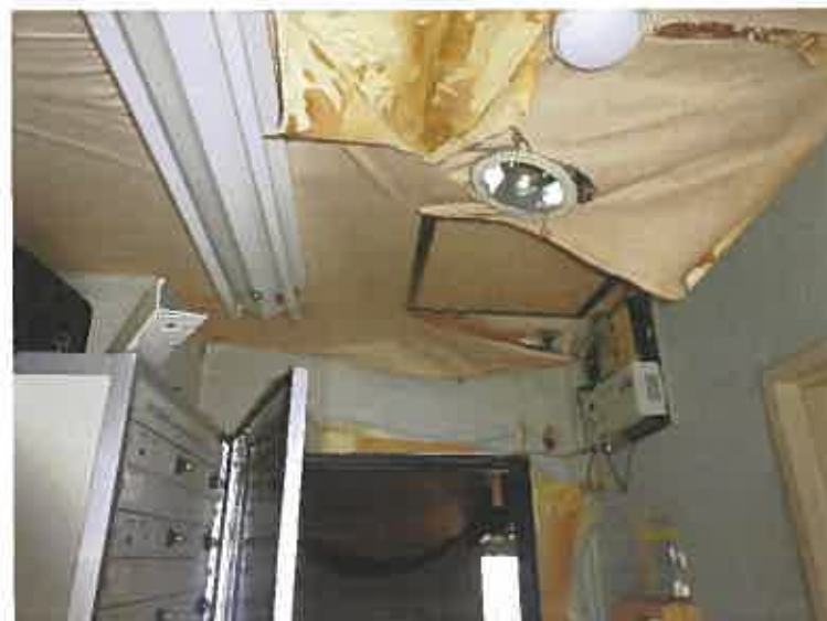
写真3 6 (本件建物 2階(雨漏りがしていると思われる箇所))
