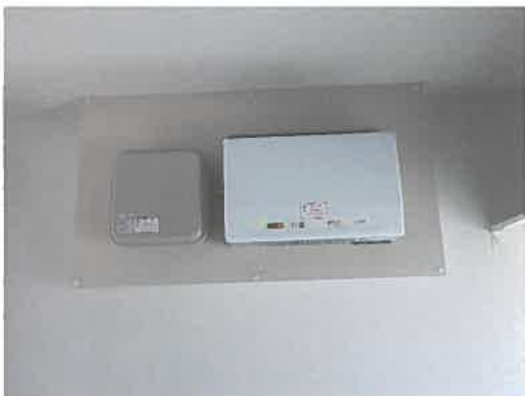
写真18 太陽光発電設備（パワーコンディショナー）
