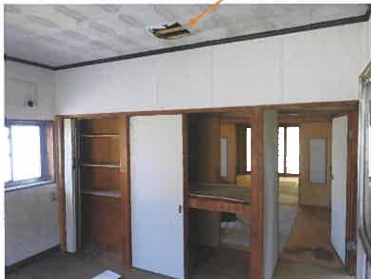
写真21 (物件2の建物 3階) 穴が空いている箇所
