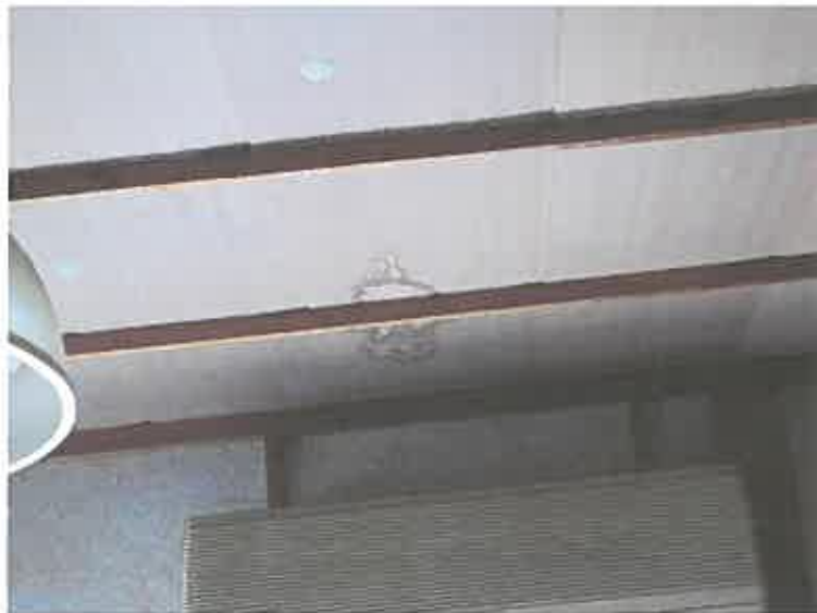
写真16 雨漏りによるものと思われる染み
