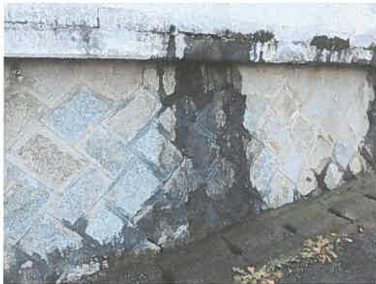
写真4 擁壁のクラック
