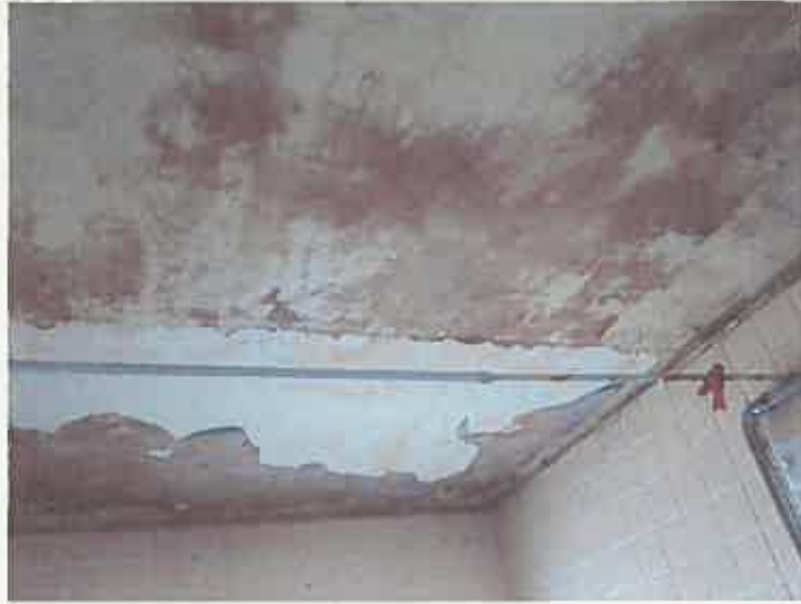
写真13 浴室天井の剥離
