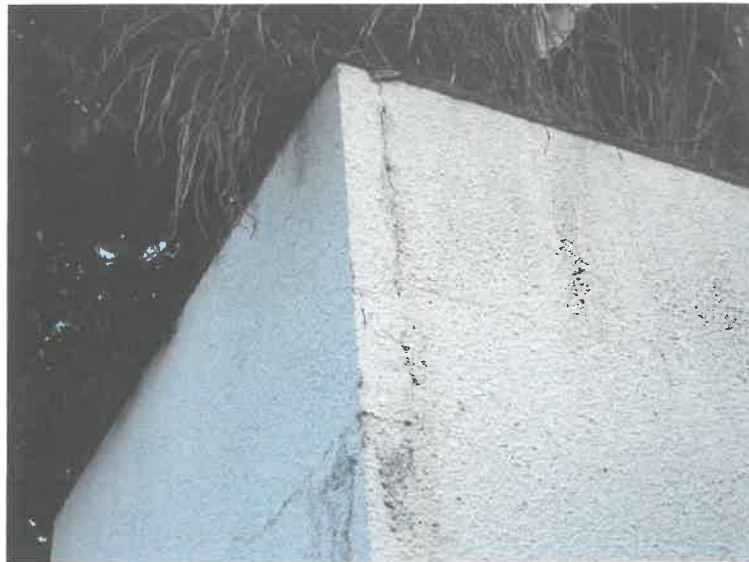
写真4 コンクリート塀のクラック
