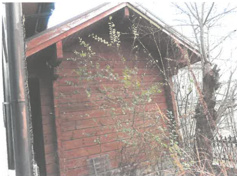
写真6 未登記附属建物
