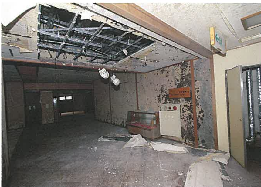
写真④ 雨漏りと電線盗
