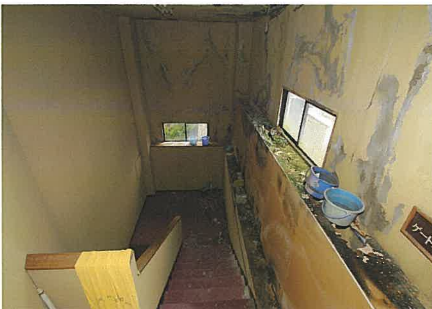
写真⑭ 5階部分 雨漏り，外壁に損傷
