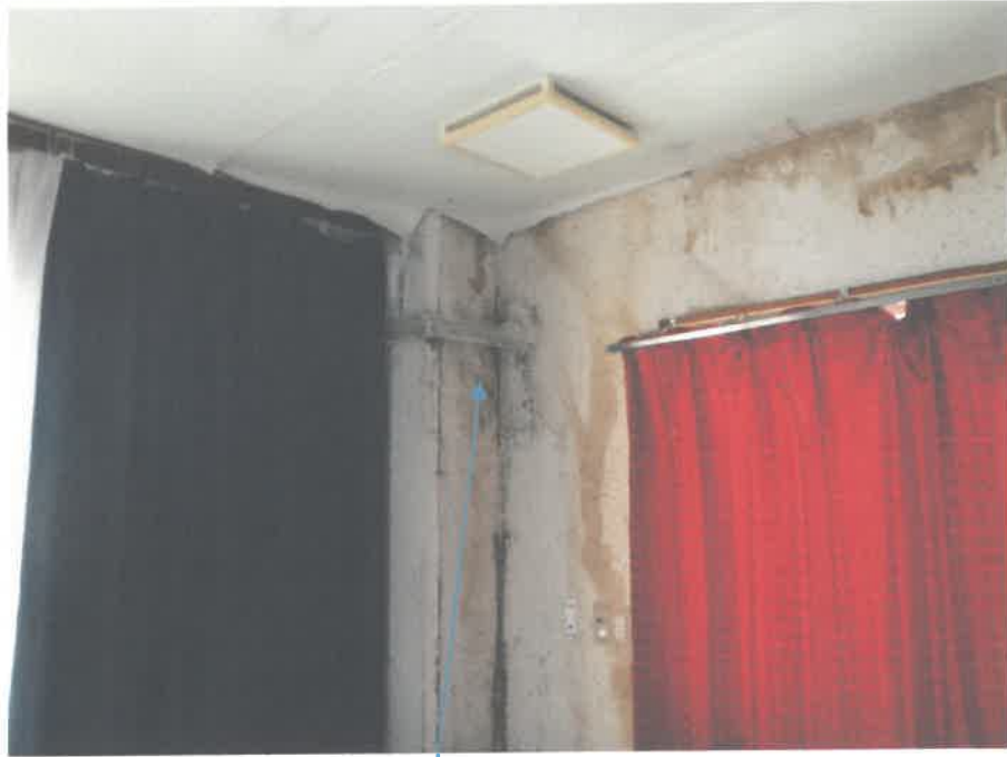
雨漏りによる腐食
